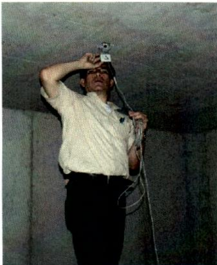
Figura 3.62 Se aprecia el proceso de colocación de los registradores.
