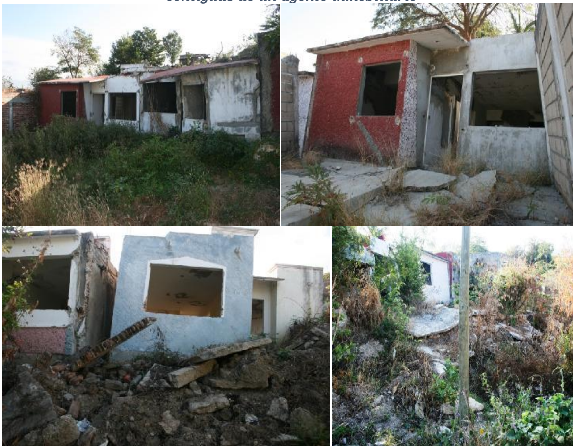
Imagen 6 Casas destruidas por la intervención de las obras contiguas de un agente inmobiliario
