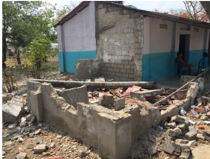
Fotografía 4.1.- Elementos estructurales inexistentes
