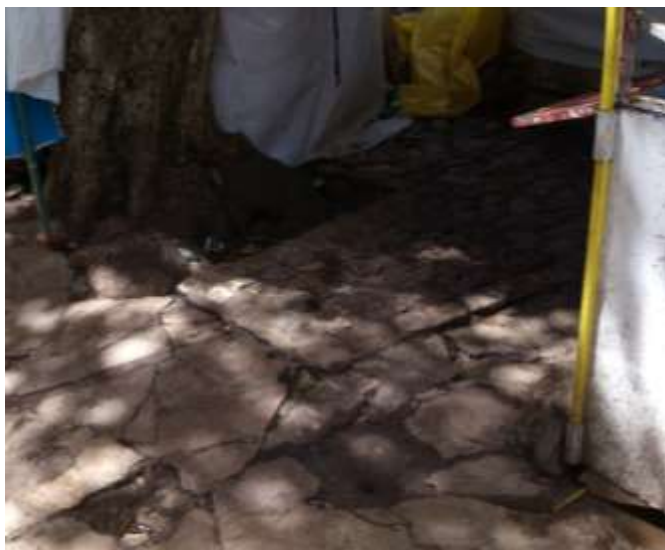
Fotografía 17 Material disgregado en andadores de la Alameda Utrilla; Foto tomada por Cordero, Mayo 2013.
