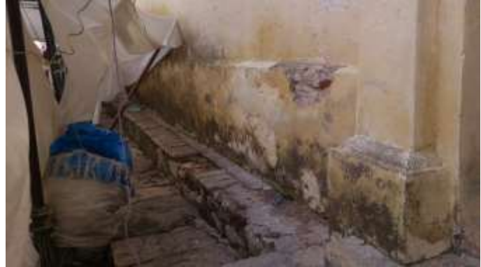
Fotografía 31 Acumulación de Humedades y disgregación de materiales en fachada de caridad; Foto tomada por Cordero mayo del 2013
