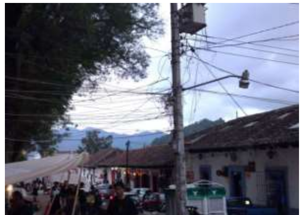
Fotografía 2, Instalaciones eléctricas riesgosas, foto tomada por Cordero 2010
