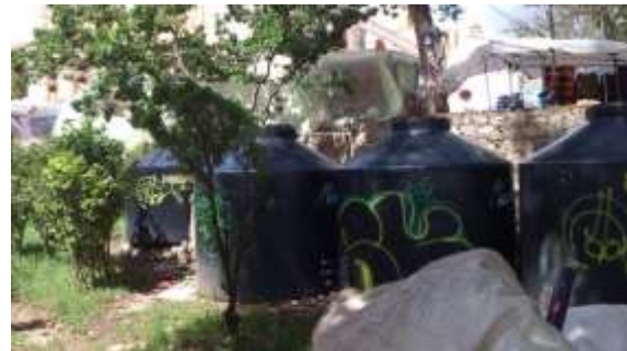
Fotografía 20 Tinacos aparentes; Foto tomada por Cordero mayo de 2013
