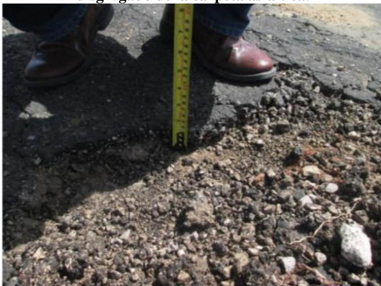
Imagen 12. Durante la verificación física de la obra se encontró material disgregado de la carpeta asfáltica.
