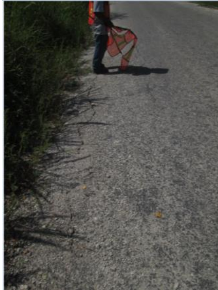
Imagen 15. Se presentan en las orillas del camino grietas longitudinales (hombros caídos) a falta de cunetas
