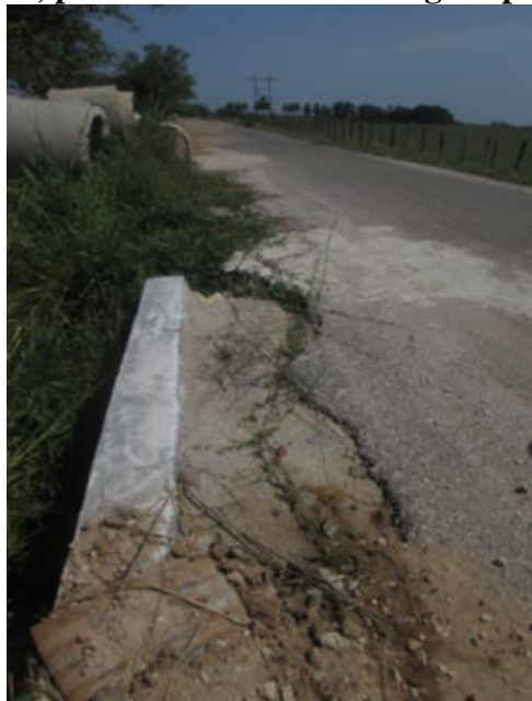
Imagen 16. En obras de drenajes no se ejecutaron losas o revestimientos de concreto, para escurrimientos de aguas pluviales
