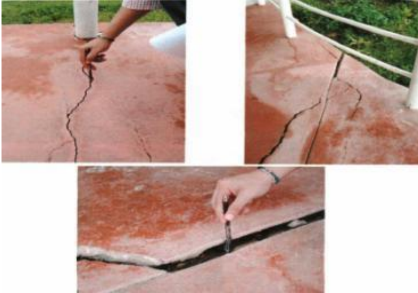
Imagen 38. Deficiencia técnica de construcción en el piso de concreto presenta grietas.
