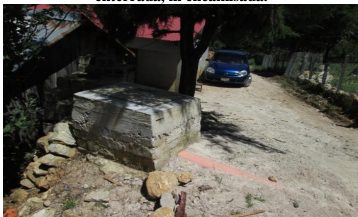
Imagen 35. Deficiencia técnica de construcción, en el alcantarillado se observa que la tubería de PVC se encuentra expuesta a la intemperie, no se encuentra enterrada, ni encamisada.
