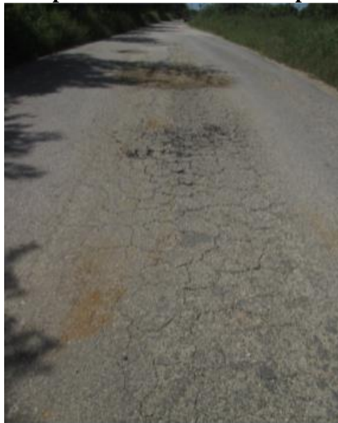
Imagen 14. La estructura del pavimento se encuentra con fallas observándose la apariencia de piel de cocodrilo en la carpeta asfáltica.
