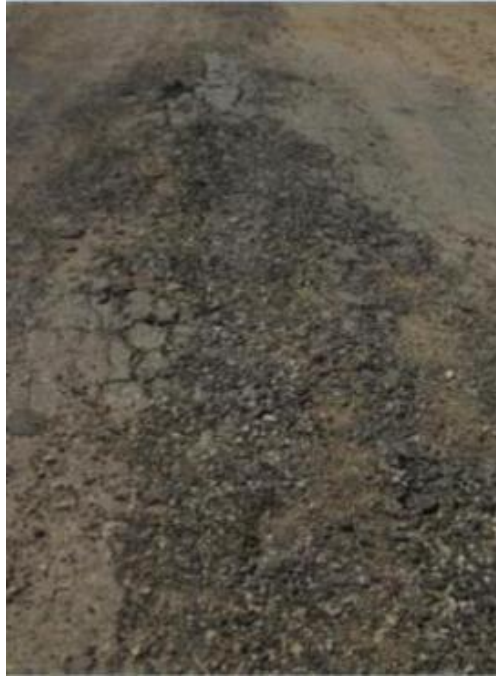
Imagen 13. Estado físico de la carpeta asfáltica.
