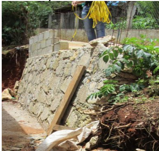
Imagen 44. El muro de contención se ejecutó con producto de demoliciones y no con piedra obtenida de banco
