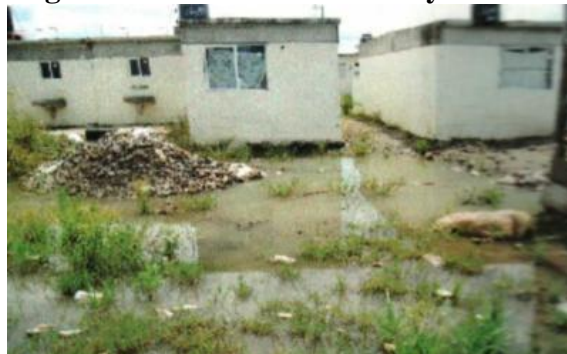
Imagen 2. Viviendas inundadas y socavadas
