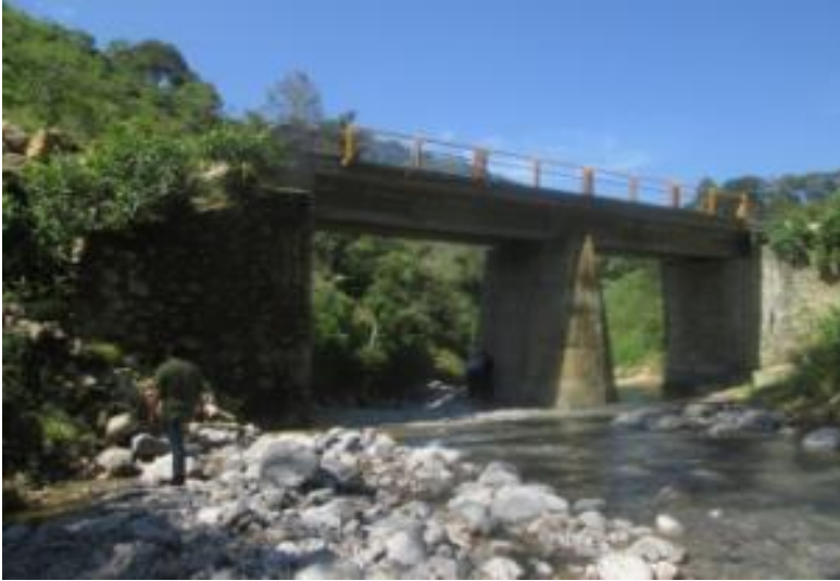
Imagen 40. Deficiencia técnica de construcción en el puente, existe socavaciones en aleros.
