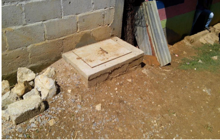
Imagen 42. Falta la cadena de cerramiento en la boca del registro sanitario
