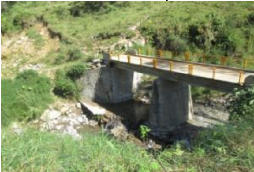
Imagen 39. Deficiencia técnica de construcción existe socavaciones en el zampeado de piedra.
