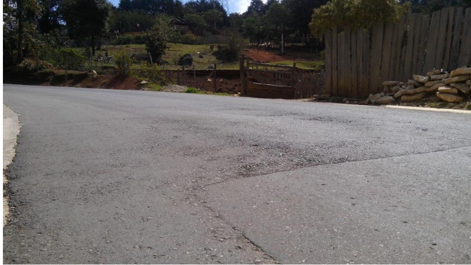
Imagen 17. Estado físico de la superficie del pavimento observese la falta de riego de sello
