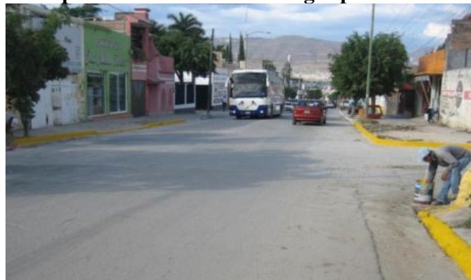
Imagen 7. Calle Dr. Samuel León Brindis en la colonia caminera se aprecia el pavimento sometido a cargas pesadas.
