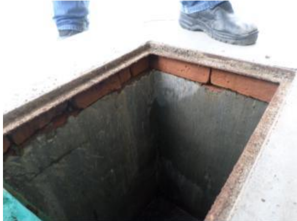
Imagen 43. Se aprecia otro registro sanitario en el que no existe cadena de cerramiento.
