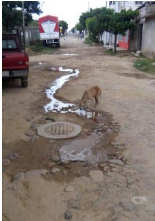
Imagen 37. Deficiencia técnica de construcción existe fuga en la línea de la red de alcantarillado.
