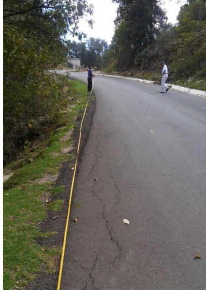
Imagen 21. Grietas en la orilla del camino (hombros caídos)
