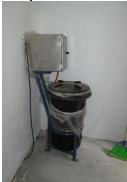
Imagen 51. Equipo de cloración de la planta tratadora de agua residuales ubicada en Galilea, Teopisca, Chiapas se encuentra suministrado y no operando.
