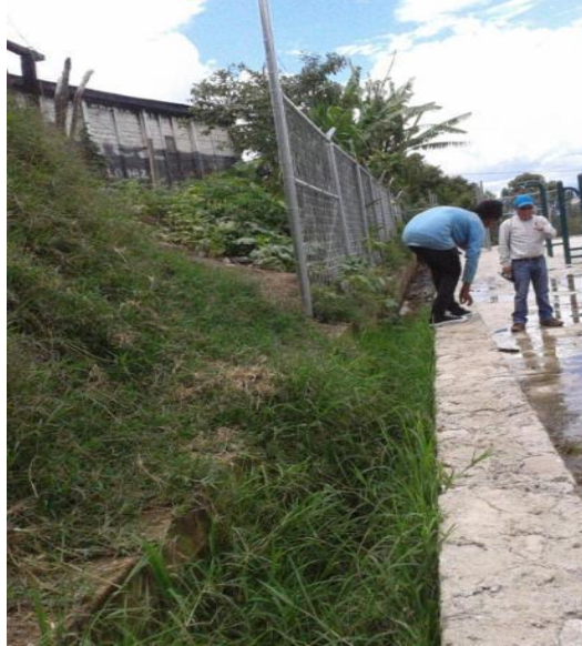
Imagen 36. Deficiencia técnica de construcción en el muro del canal, se filtra el agua.
