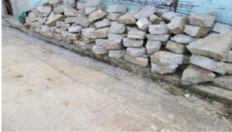
Imagen 45. Se observa material producto de demoliciones proveniente de la zanja en calles utilizado para la construcción de muros.
