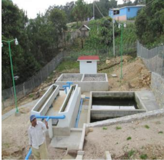
Imagen 50. Obra de planta tratadora de agua residuales ubicada en Galilea, Teopisca, Chiapas se encuentra terminada y no operando.
