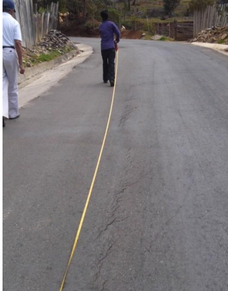
Imagen 19. Grietas longitudinales en la superficie del pavimento además de notarse los hundimientos y ondulaciones en el centro de línea de este tramo
