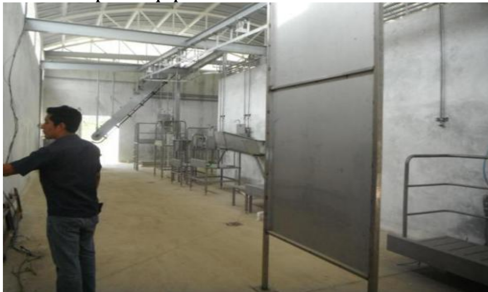
Imagen 53. Obra rastro municipal de Ocosingo, Chiapas, se encuentra inconclusa y no opera el equipamiento se realizó con otro contrato.
