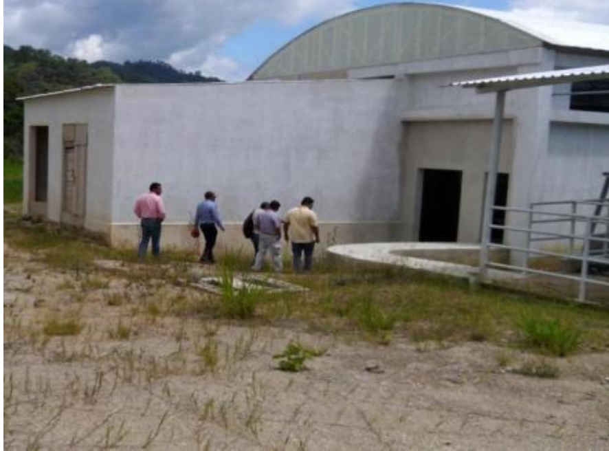
Imagen 52. Obra rastro municipal de Ocosingo, Chiapas, se encuentra abandonado, se observa como obra inconclusa y sin operar.
