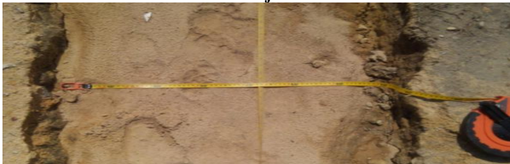
Imagen 30. Debido a la falla por asentamiento, se puede medir el ancho real de la zanja.
