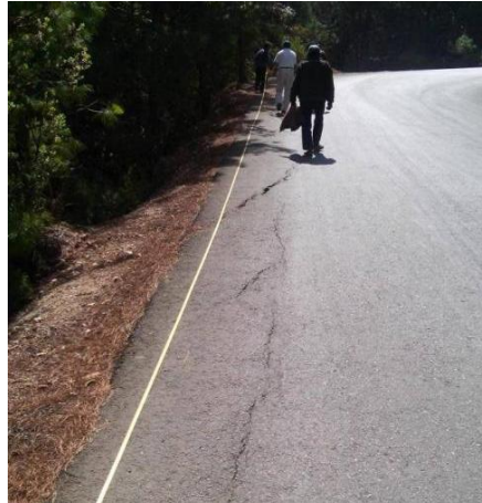
Imagen 20. Grietas en la orilla del camino (hombros caídos)
