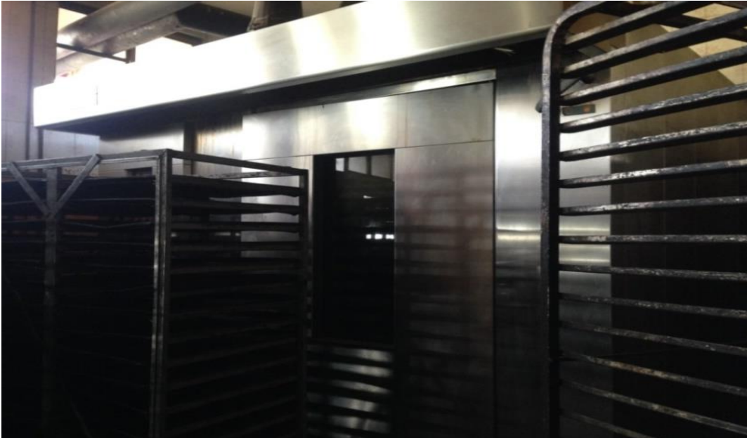
Fotografía 07 Mantenimiento del horno eléctrico.
