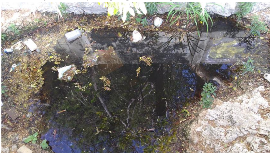
Apéndice 9. Imagen 2 de arroyo Chapultepec obsoleto por falta de mantenimiento.
