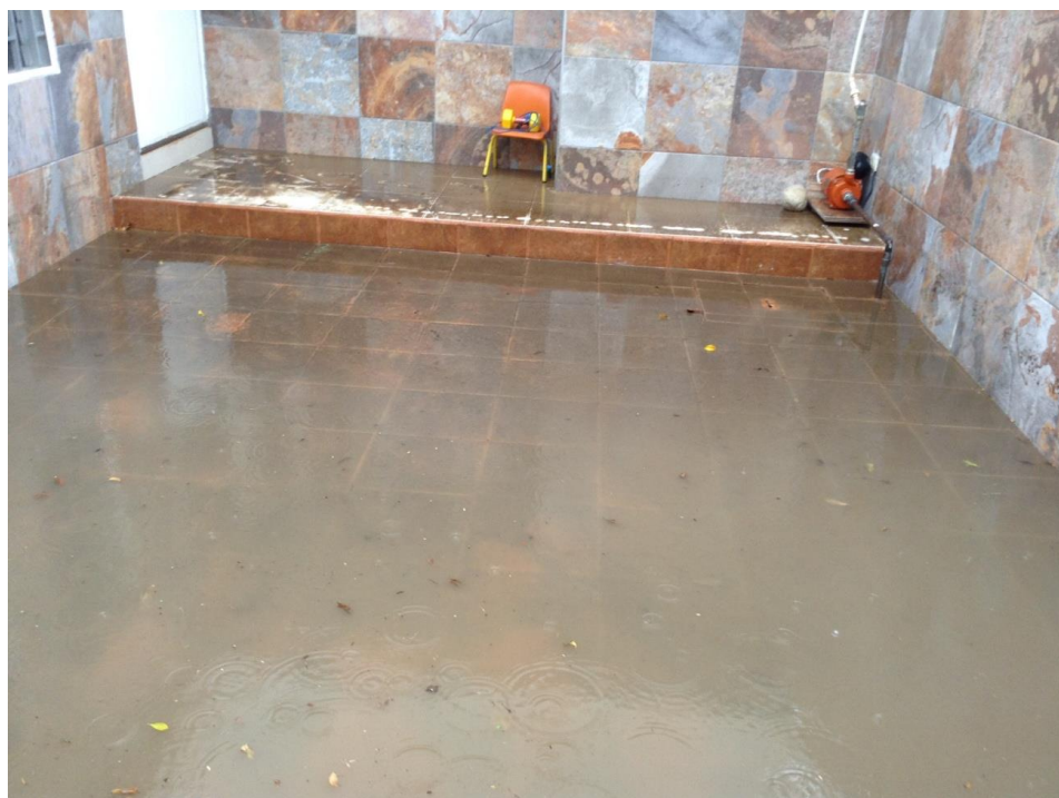
Apéndice 18. Imagen de aguas negras y pluviales en interior de vivienda, filtración a cisterna.
