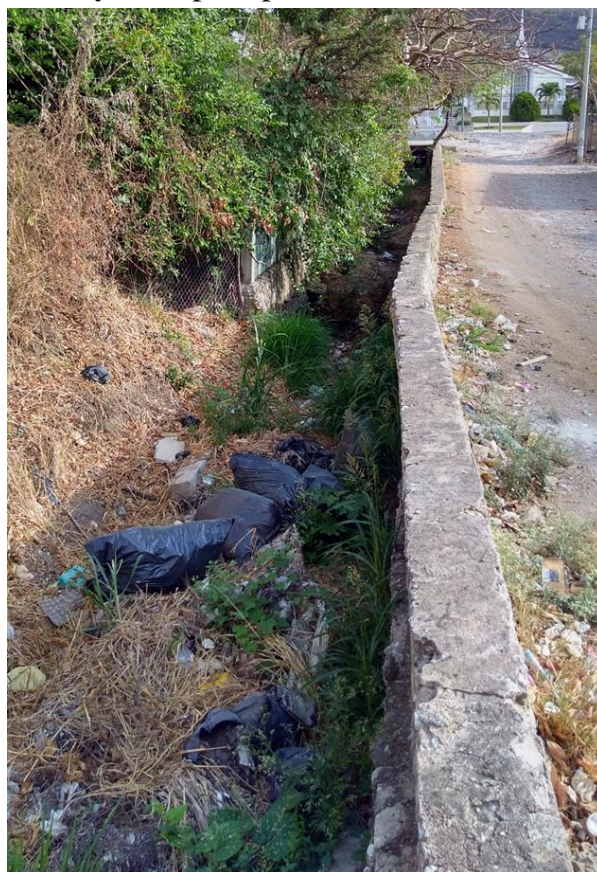
Apéndice 7. Imagen 2 de arroyo Chapultepec con tramo de muro colapsado.
