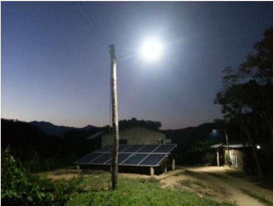
Imagen 60. Luminaria en funciones en El Tuzal
