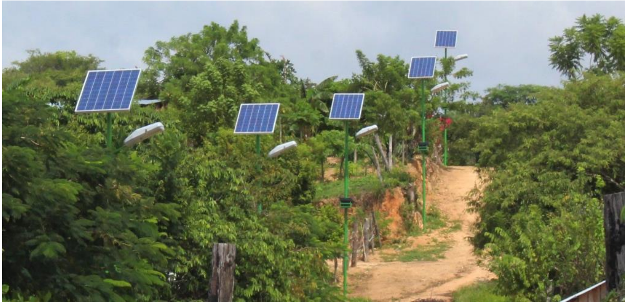
Imagen 68. sistemas fotovoltaicos para iluminación exterior en Villa del Rio
