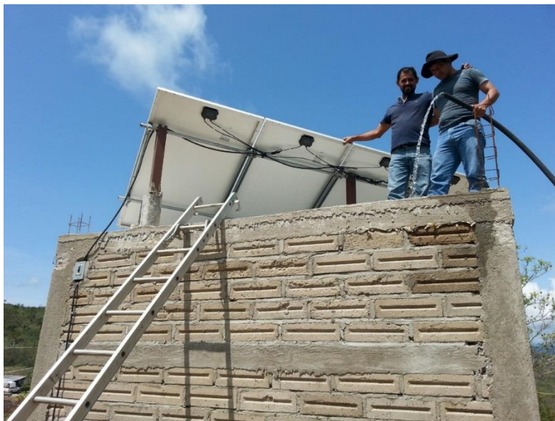
Imagen 35. Tanque y sistema fotovoltaico de El Tuzal
