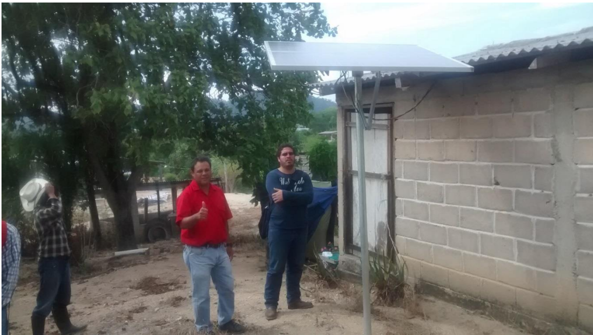
Imagen 56. sistema fotovoltaico que alimenta al refrigerador comunitario de El Tuzal
