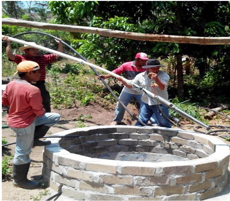
Imagen 36. Pozo de agua que alimenta al tanque de El Tuzal.
