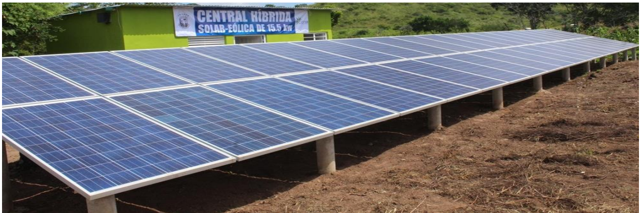
Imagen 69. sistemas fotovoltaicos central en Villa del Rio
