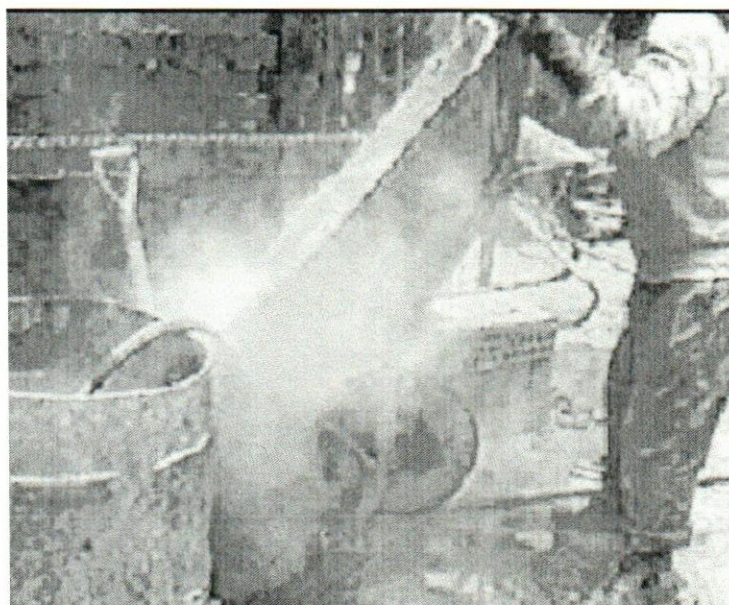
Figura 15. Polvo en exceso en los agregados.
