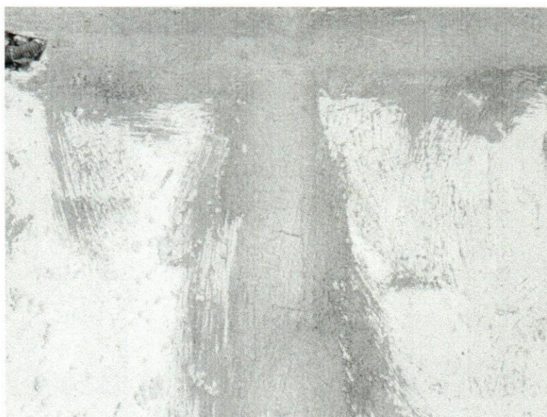
Figura 63 Fisuras en muros
