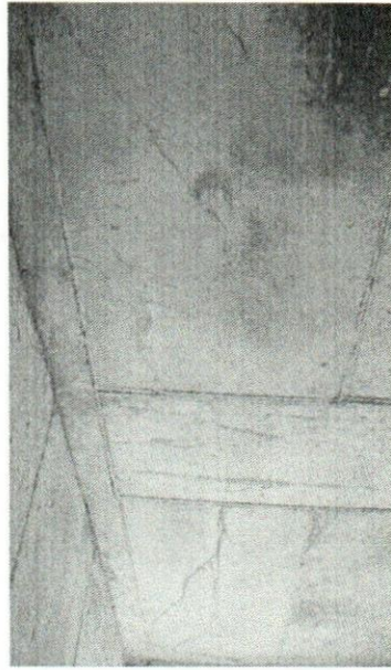
Figura 20. Agrietamiento por retiro prematuro del apuntalamiento central
