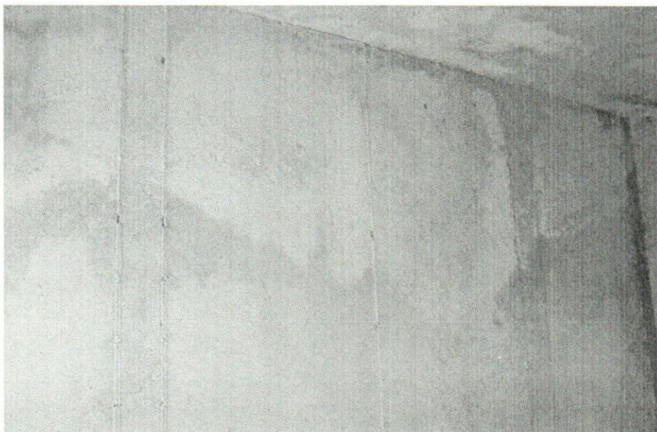
Figura 27. Junta Fría en el Concreto
