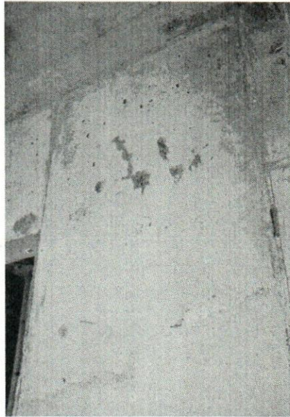
Figura 26. Retardo en el fraguado por sobredosificación de aditivos.
