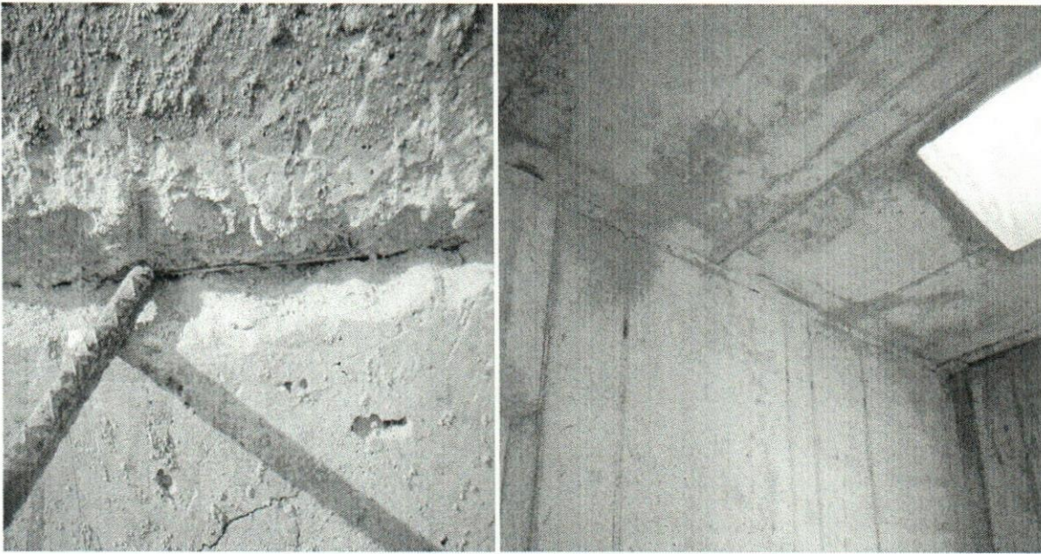
Figura 24. Fisuras perimetrales en la unión losa-muro.
