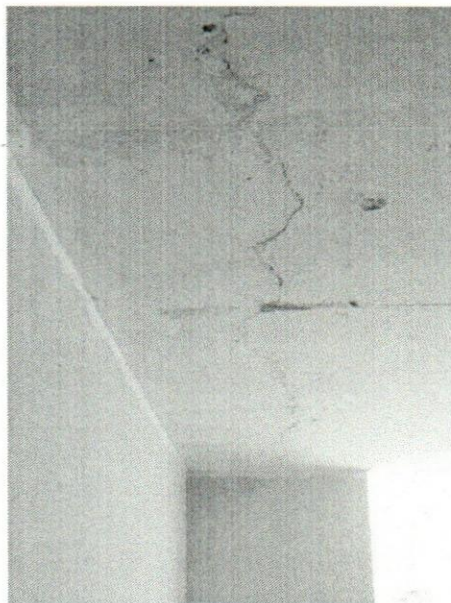
Figura 14. Fisuras por contracción de secado.
