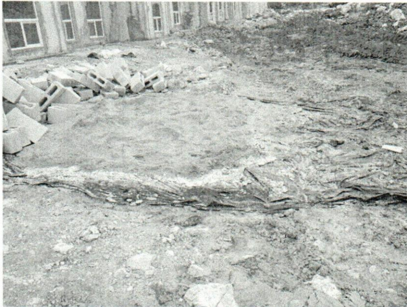
Figura 61 Contaminación de materiales de construcción
