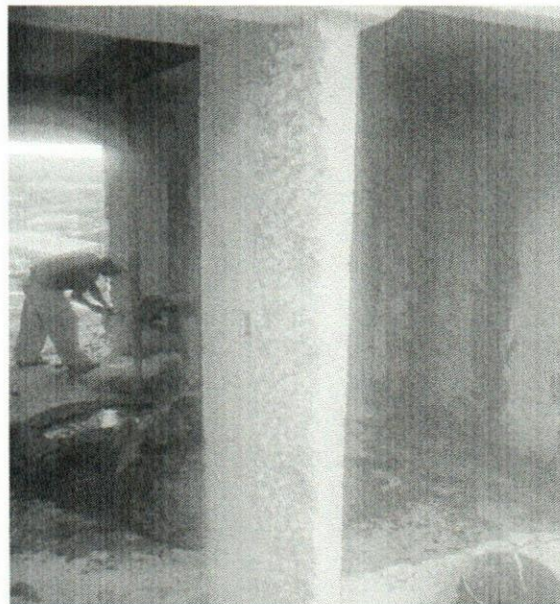
Figura 25. Falta de alineación en la cimbra
