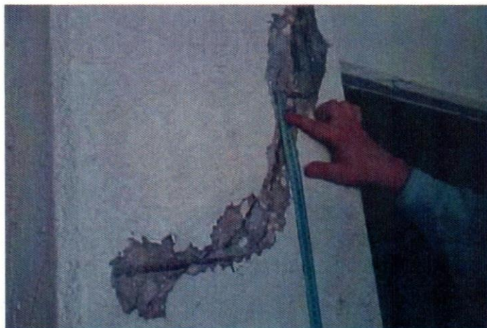
Figura 48: Daños en columnas (Aguilar Carboney, Jorge,1995)
