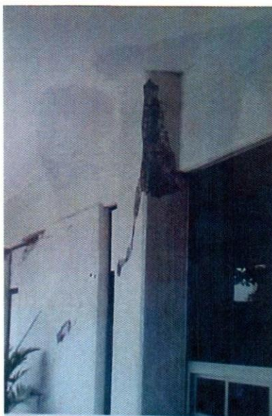
Figura 47: Daños en columna con pretil superior (Aguilar Carboney, Jorge1995)
