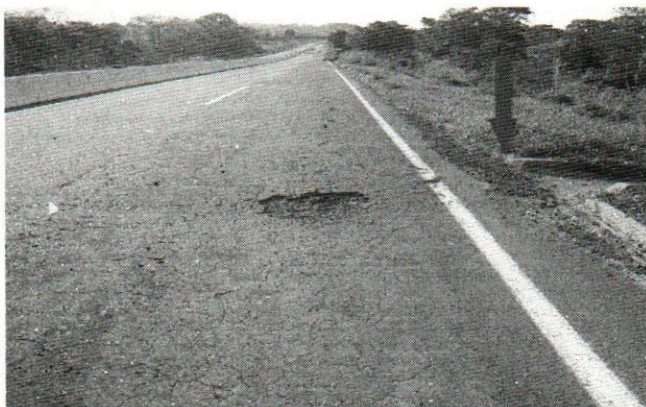
Figura III.16. Falta de Bordillo
