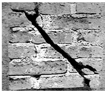
a) Falla por las piezas
