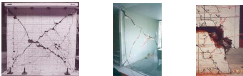
Figura 2.11 Penetración de grietas inclinadas en los extremos de castillos y plegamiento de las barras longitudinales (Aguilar, 1997)
