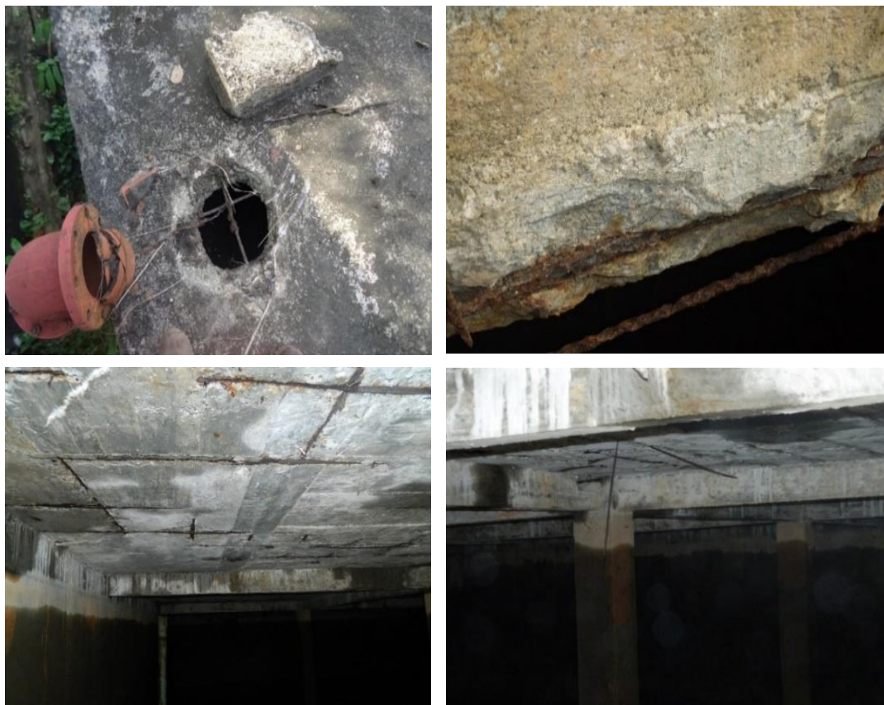
Figura 11 Tanque regulador existente.
