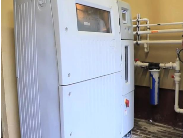
a) Equipo generador de hipoclorito
