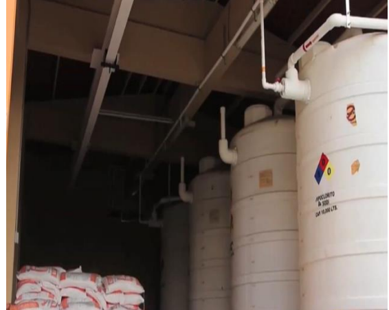
b) Contenedores de Hipoclorito de sodio
