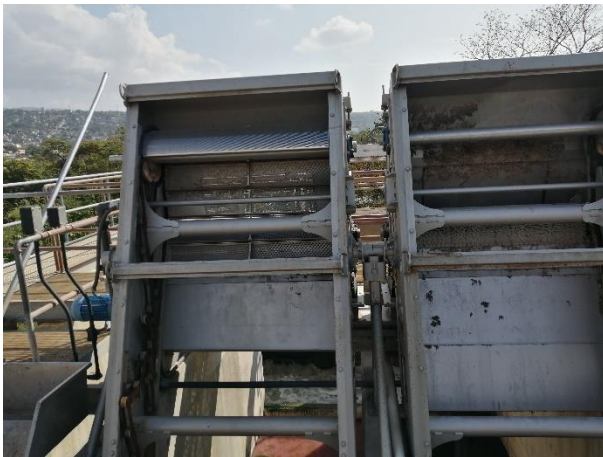
a) Vista en la llegada del agua residual y arena al cribado
