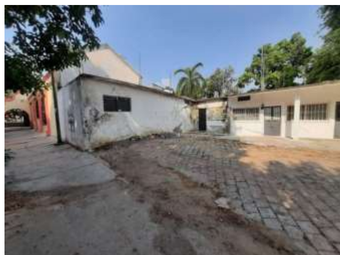
Fotografía 4.15 y 4.16.- Parte trasera y lateral de iglesia de Santa Cecilia, construcción en peligro por estar sobre el embovedado. Se pueden notar varias ranuras en la estructura de las casas, así como deterioro por el paso del agua.
