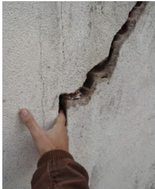
Figura 3.11 Grieta con más de 5 mm de ancho, apta para rehabilitación por medio de inserción de rajuelas (Rocamora, 2014).
