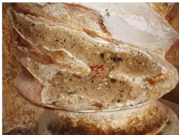
Fig. 69. Detalle argamasa columnas. Foto: Constantino Armendáriz
