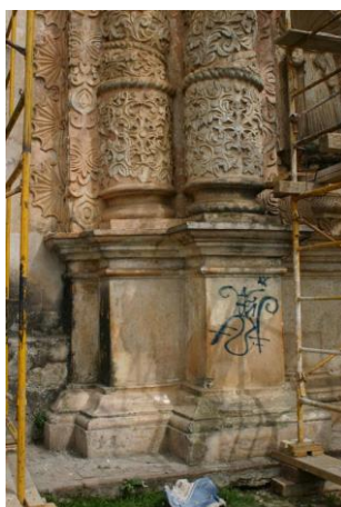
Fig. 58. Imagen basamento antes de la restauración. Foto Haydeé Orea, 2006
