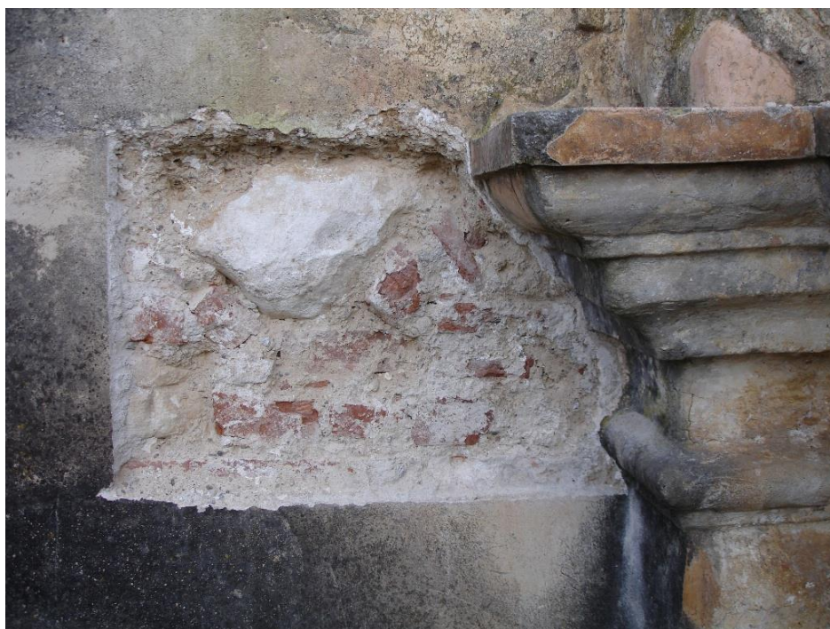
Figura 27. Cala realizada durante los trabajos de conservación en uno de los muros que soportan la fachada y que evidencia los materiales empleados: ladrillo y piedra, rejunteados con morteros de cal y arena, y la ausencia de un aplanado pintado sobre el soporte. Mayo del 2006.
