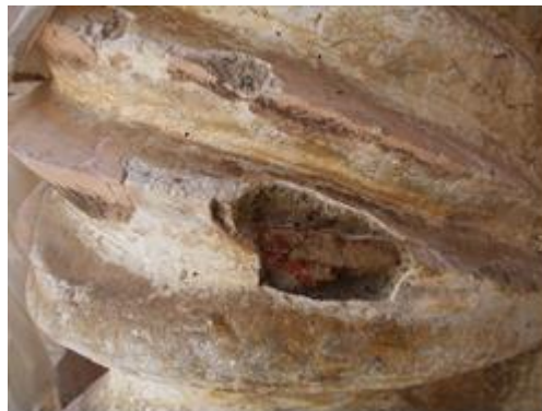
Fig. 65. Cala realizada en un resane de una columna del tercer cuerpo.
