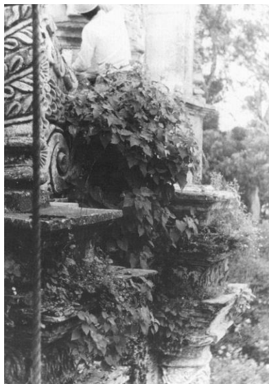
Figura 44. Aspecto de la vegetación que crecía sobre la fachada, tomada del informe de los trabajos de conservación efectuados por el Arq. Guerrero del año 1974 785
