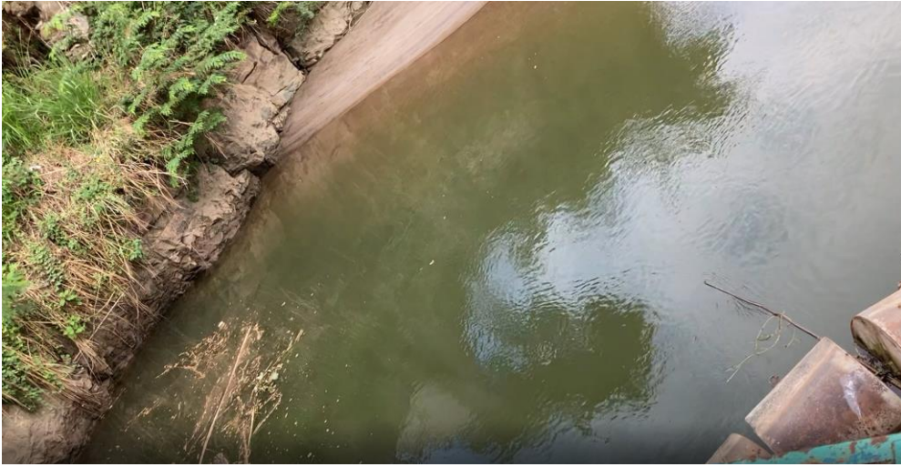
Sedimentos y basura dentro de obra de toma actual. (Fuente propia 2023).
