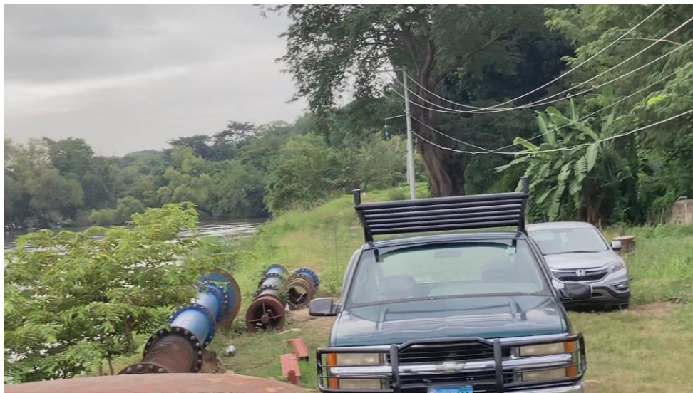
Zona donde se planea construir la obra de toma de Ciudad del Agua. (Fuente propia 2023).
