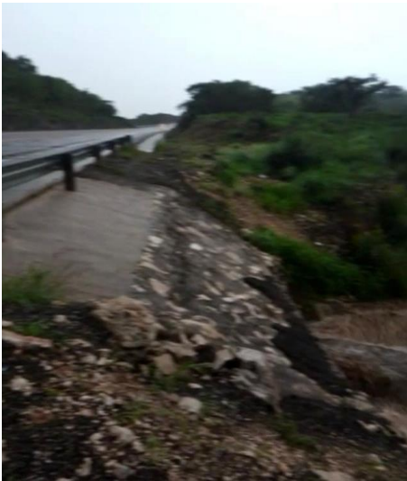
Figura No. 1. Obra de drenaje 91+989 durante la lluvia extraordinaria.
