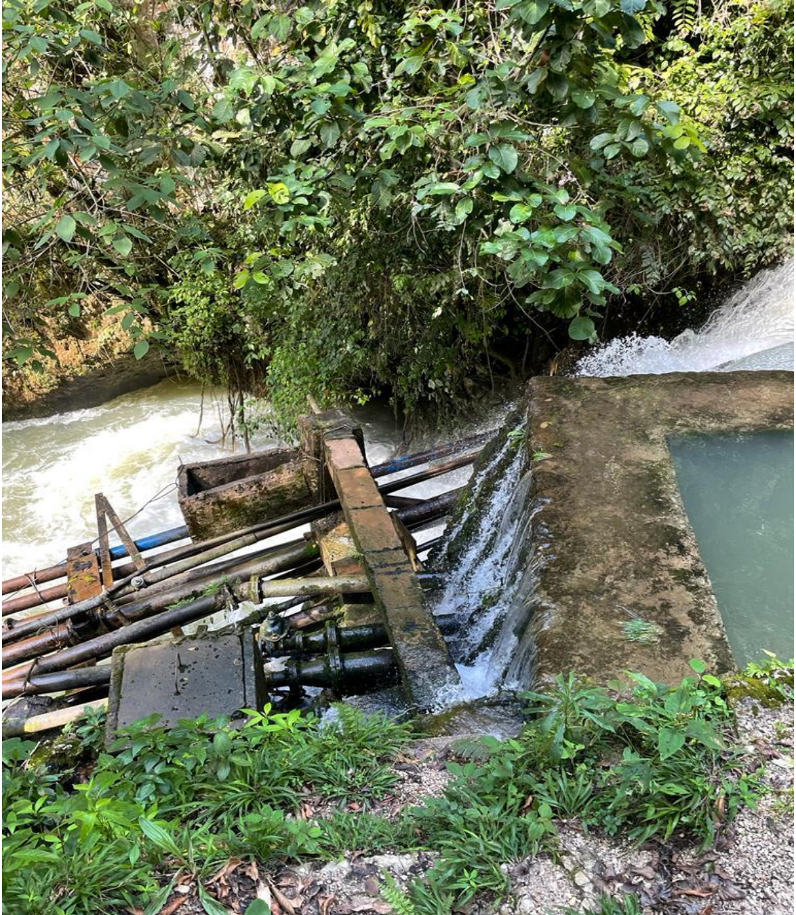
Foto 3. Tuberías de las localidades de Tenejapa
