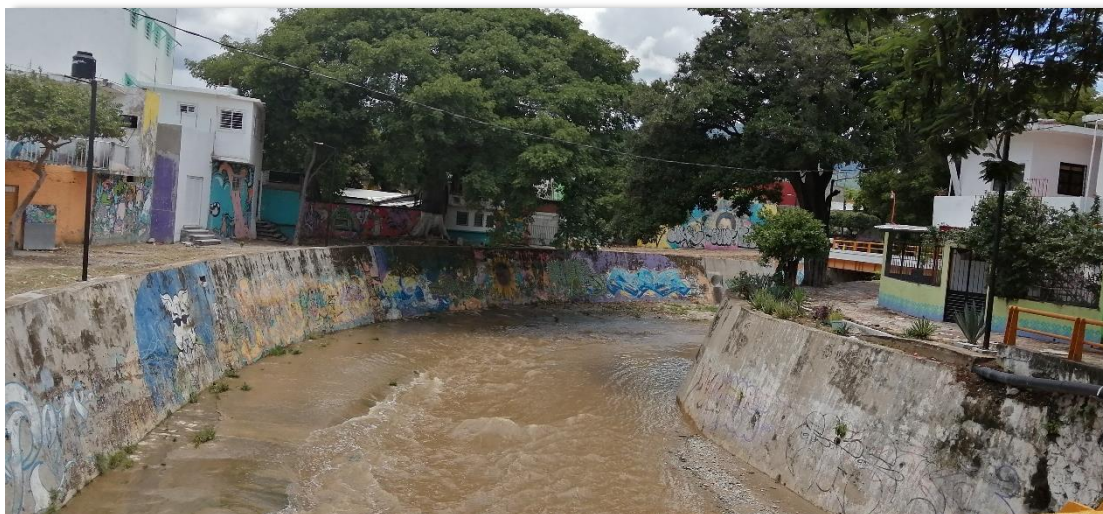
Puente de la 5 Av. Norte entre 1ª oriente y Calle Central. Foto 176.
