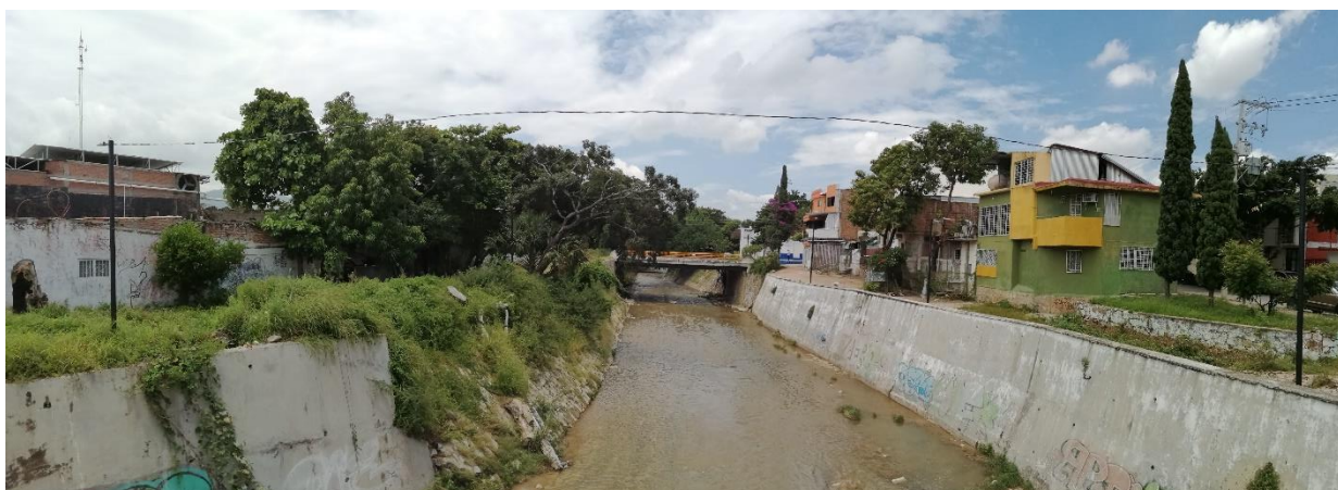
Puente y andadores de la 10ª Poniente entre 4ª y 5 Av. Norte, aquí se puede contemplar otros andadores deteriorados. Fotografía tomada viendo hacia el lado oriente.
