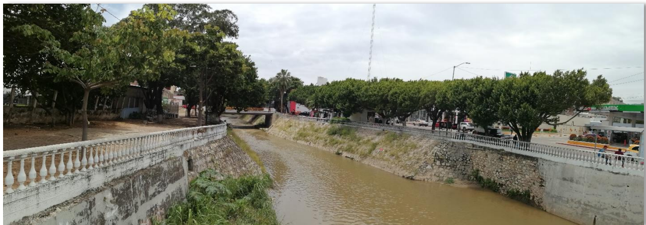
Puente y andadores de la 6ª Poniente entre 4ª y 5 Av. Norte, foto tomada hacia el poniente. Foto 190.
