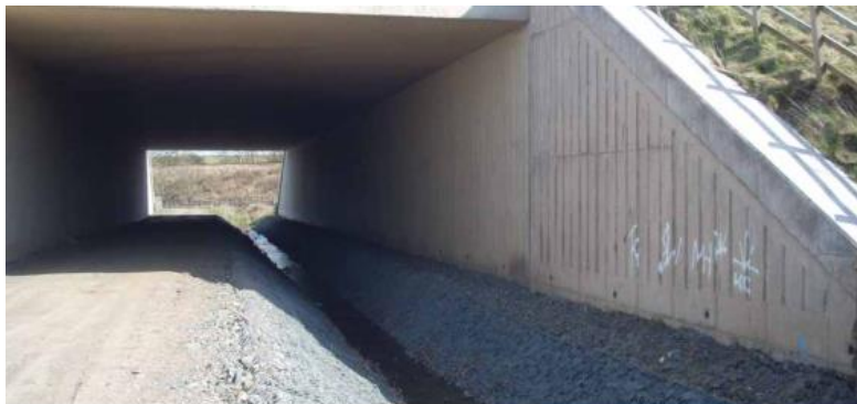
Figura 48. Alcantarilla con adaptación de un pequeño canal al centro para permitir circular a la fauna acuática
