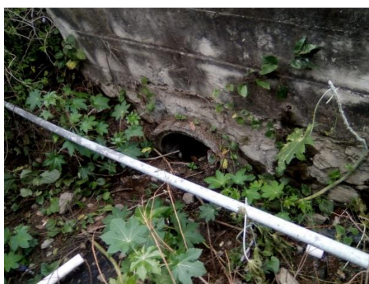
Figura 46. Tubo de concreto en estado azolvado por vegetación y arrastres. Fuente: Propia.
