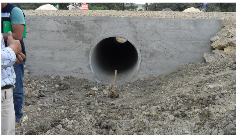
Figura 10. Alcantarilla tipo tubo de concreto. Fuente (Propia)
