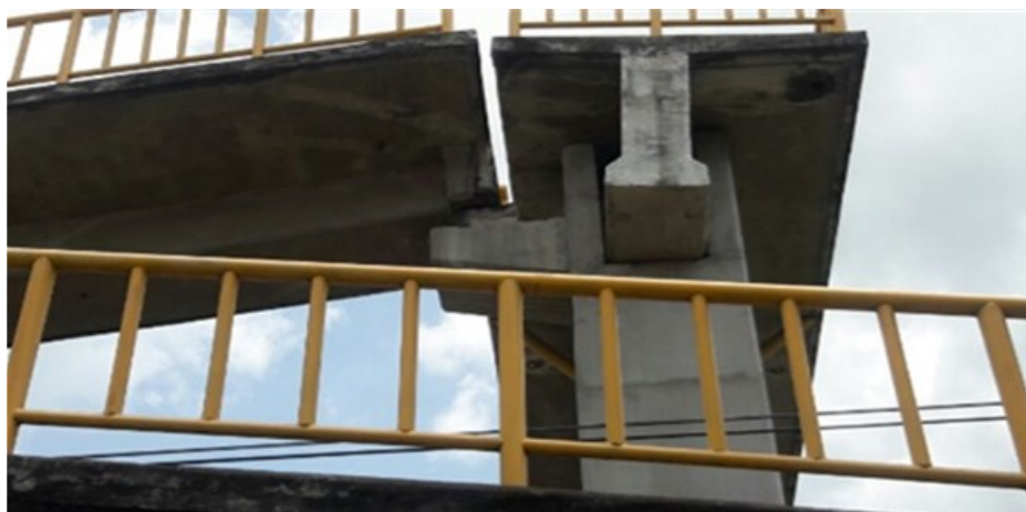
Figura 4.8 Falla provocada por el sismo de 8.2 grados del 7 de septiembre en el puente 13 + 790 del tramo Tapachula-Cd. Hidalgo (Bonilla, 2017)
