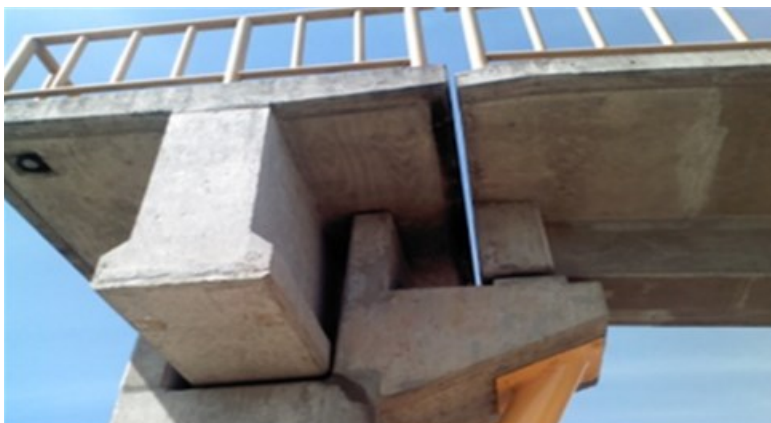
Figura 4.7 Grieta resanada en la base de la ménsula
